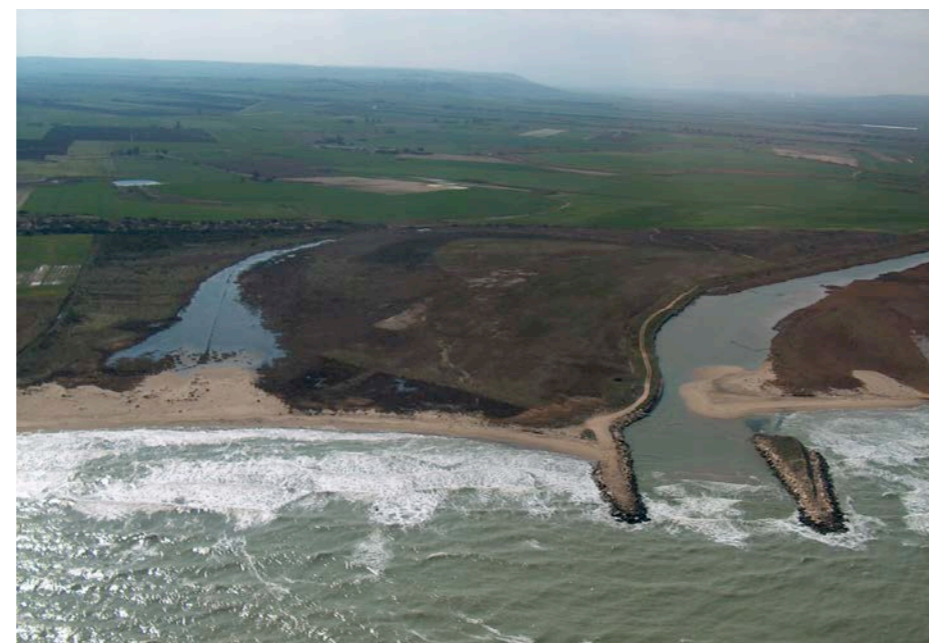
Foce del Fortore: l'armatura è danneggiata: il braccio di ponente è ormai distaccato dalla spiaggia
